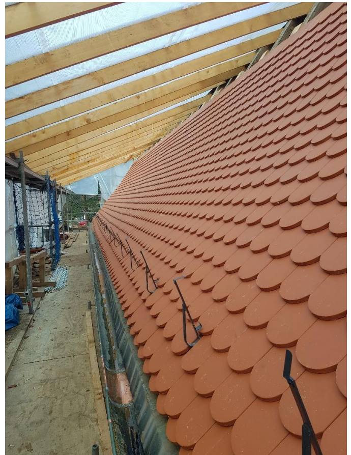
Mit neuen Ziegeln eingedeckter Bereich des Daches über dem Langhaus der Pfarrkirche. Foto: Hermann Mader
